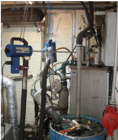
Kuva 4: Centrian kaasunpuhdistuslaitteisto ja analysaattorien näytteenottopäät
